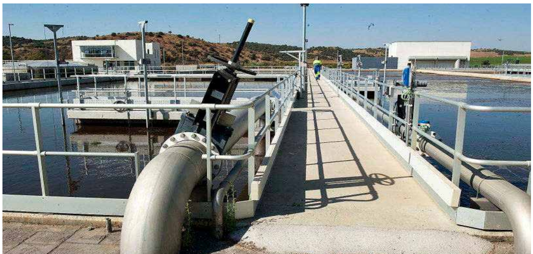
Instalaciones de la depuradora de Estiviel. / YOLANDA LANCHÁ
